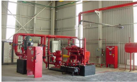
REDES PROTECCIÓN CONTRA INCENDIO
