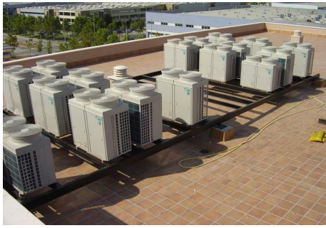
REDES DE AIRE ACONDICIONADO
