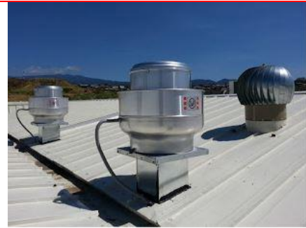
REDES DE VENTILACIÓN MECÁNICA
